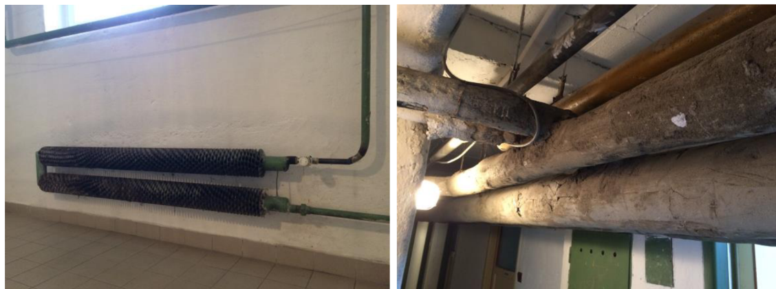
Obrázek 9 Konvektor v prádelně, ležaté rozvody v technickém podlaží
