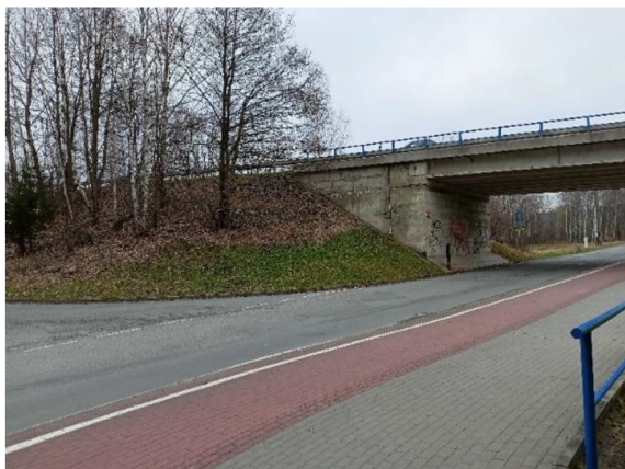
Obrázek 16: Silniční násep zpevňující silnici 1. třídy I/60 v Jeseníku nedaleko průmyslové zóny Za Podjezdem (foto: autor, 2024)
