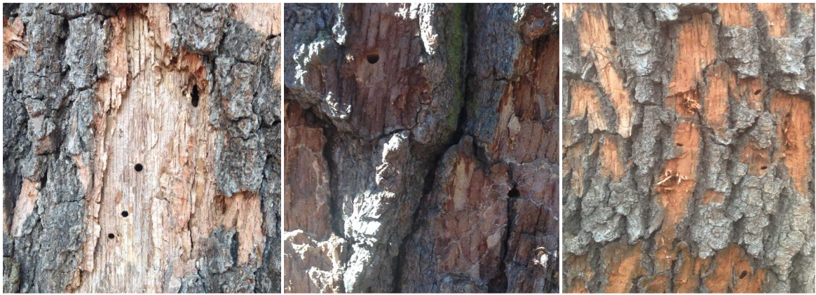
Příloha 20 – poškození – výletové otvory
