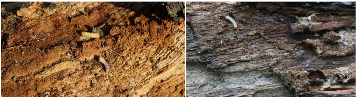
Příloha 22 – poškození – larvy – tesařík a krasec
