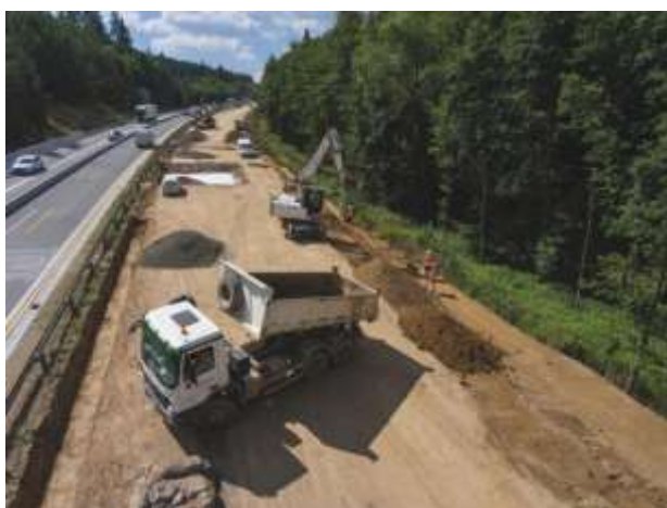
Obrázek č. 16 Odtěžení konstrukčních vrstev původní vozovky a rozšíření zemního tělesa dosypáním zeminy ve shodném sklonu (URL 16)
