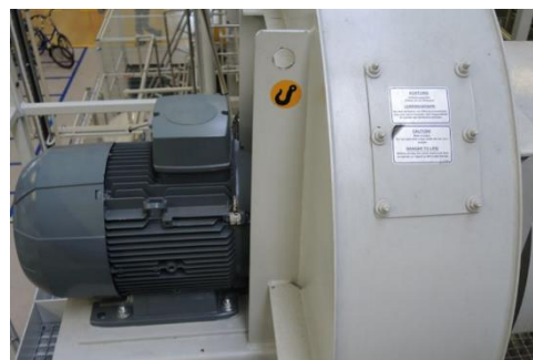
Obrázek 21: Motor pro přívod studeného vzduchu do solné lázně.
