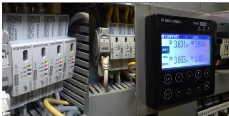
Obrázek 33: Instalovaný systém SOCOMEC v rozváděcí skříni.
