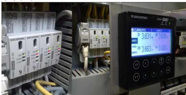
Obrázek 33: Instalovaný systém SOCOMEC v rozváděcí skříni.
