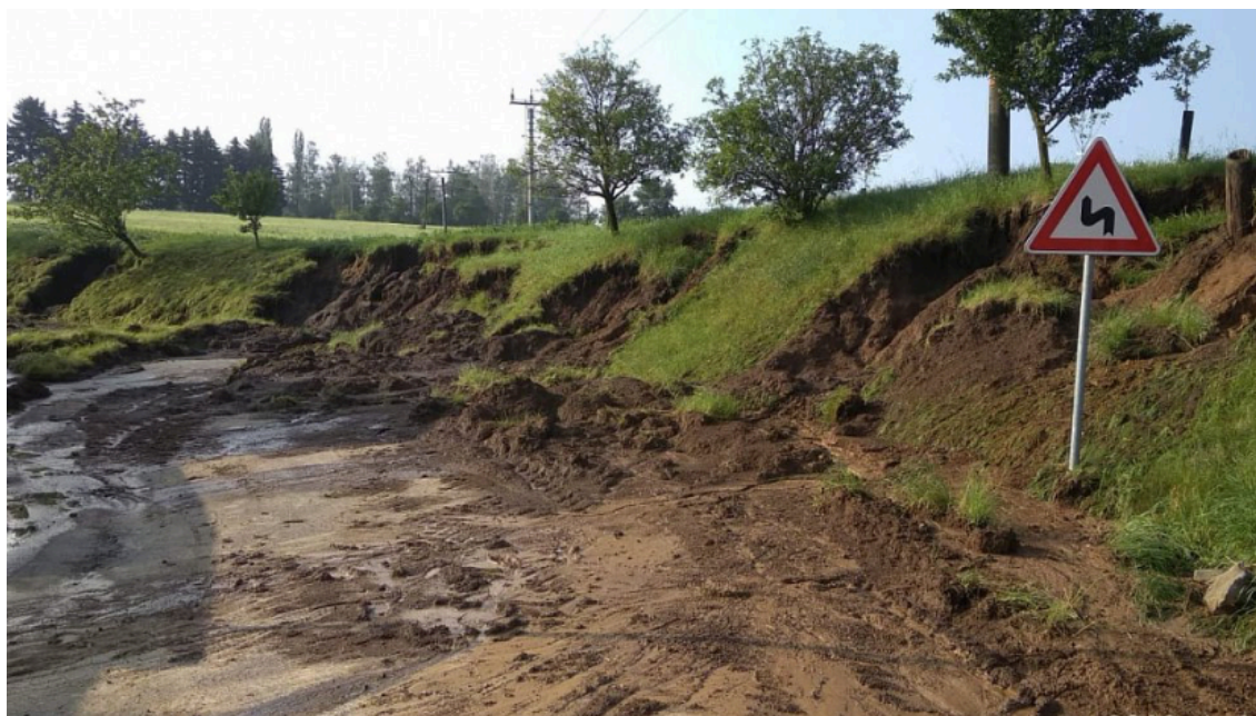
Obrázek 9. Sesunutý svah na vozovku o obce Pavlovice na Prostějovsku (Denik.cz, 2019)
