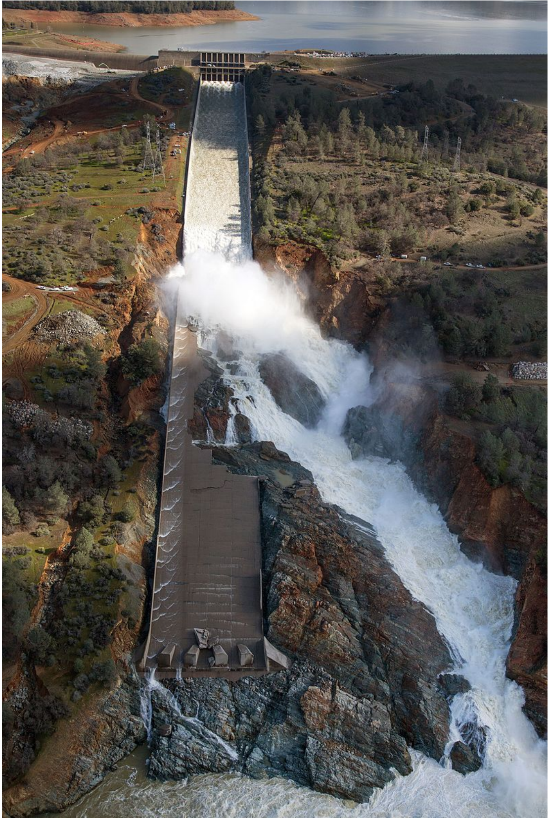
Obrázek 16. Poškozený bezpečnostní přeliv přehrady Oroville (foto: Dale Kolke zdroj: California department of water resources, 2017)
