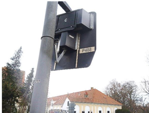
Obr. 19: Číslo přejezdu na světelné skříně
