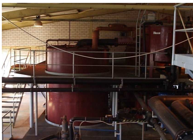
Obr. č. 2: Část technologického vybavení ČDV
