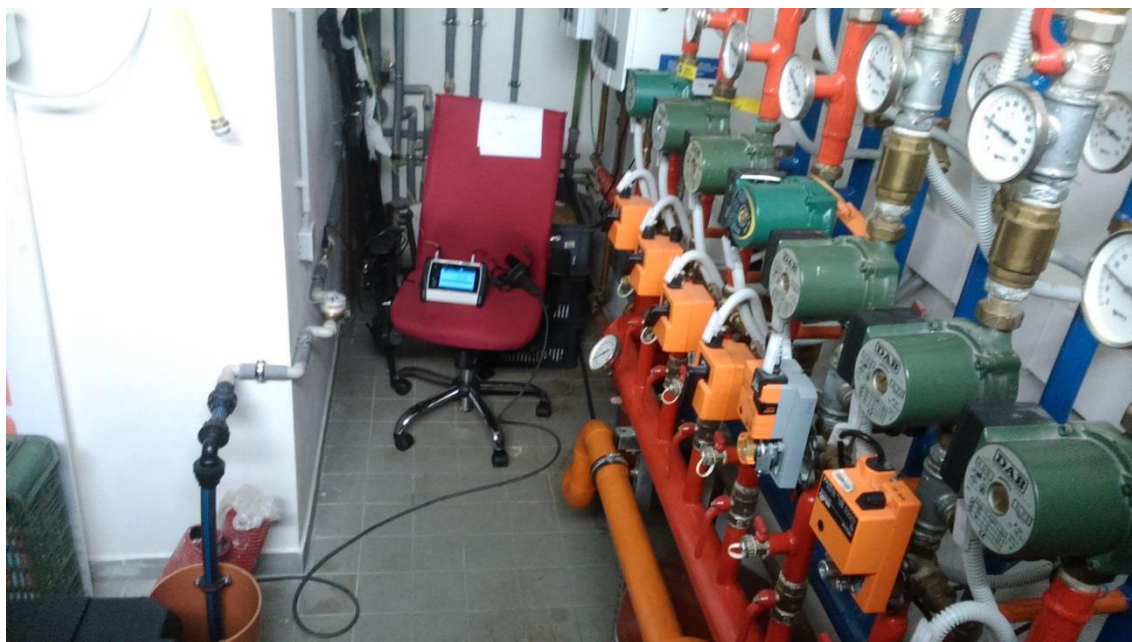
Obr. 34: Pohled do technické místnosti v Administrativní budově
