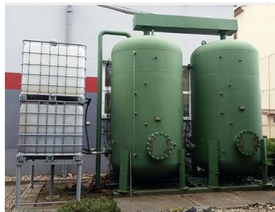
Obr. 20: Sestava nadzemních nádrží
