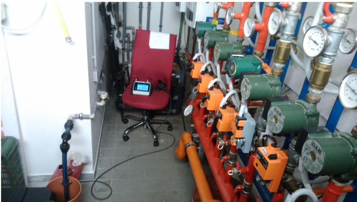
Obr. 34: Pohled do technické místnosti v Administrativní budově
