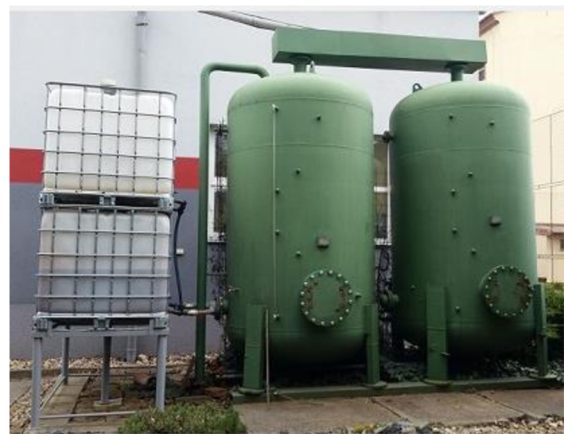
Obr. 20: Sestava nadzemních nádrží
