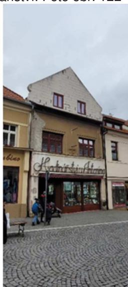
Obr.133. Nedokončená úprava fasády (dostavba štítu), ul. Palackého
