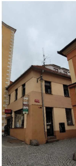
Obr.128.TV anténa na hodnotném objektu, ul. Kostelní
