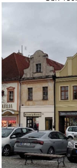
Obr. 131. Neudržovaná fasáda hodnotného objektu, Husovo nám.
