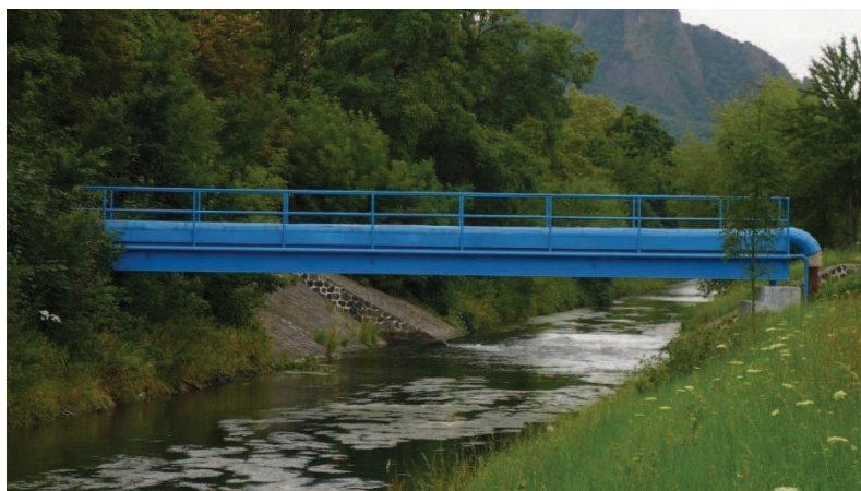
ř. km 34,4519 – potrubní lávka pod stupněm ve dně – pohled proti vodě Zdroj: Autor DP
