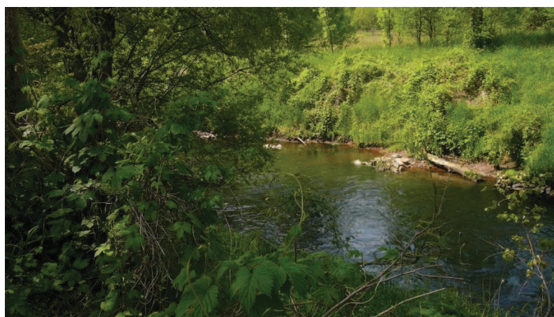
ř. km 31,7 – pod betonovým mostem – poškozené opevnění (levý břeh), pohled proti vodě Zdroj: Autor DP
