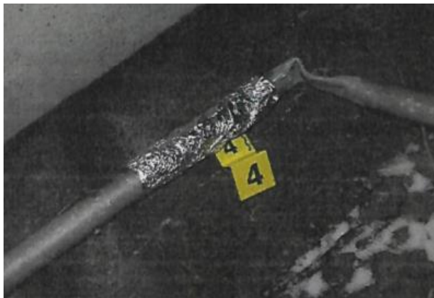
Obrázek č. 5 - Poškozená část vzdálenostního upozornovadla
