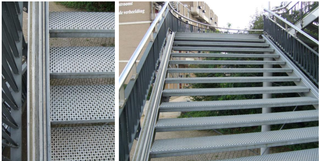
Obr. č. 13. Lišty pro vedení kola k železniční zastávce ve městě Nijmegen (NL). Zdroj: vlastní
