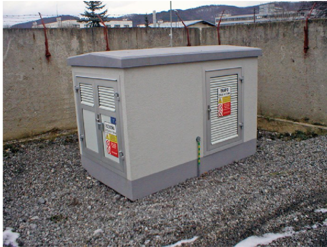
Obr. 2.3: Kiosková transformačná stanica používaná hlavne v obytných častiach
