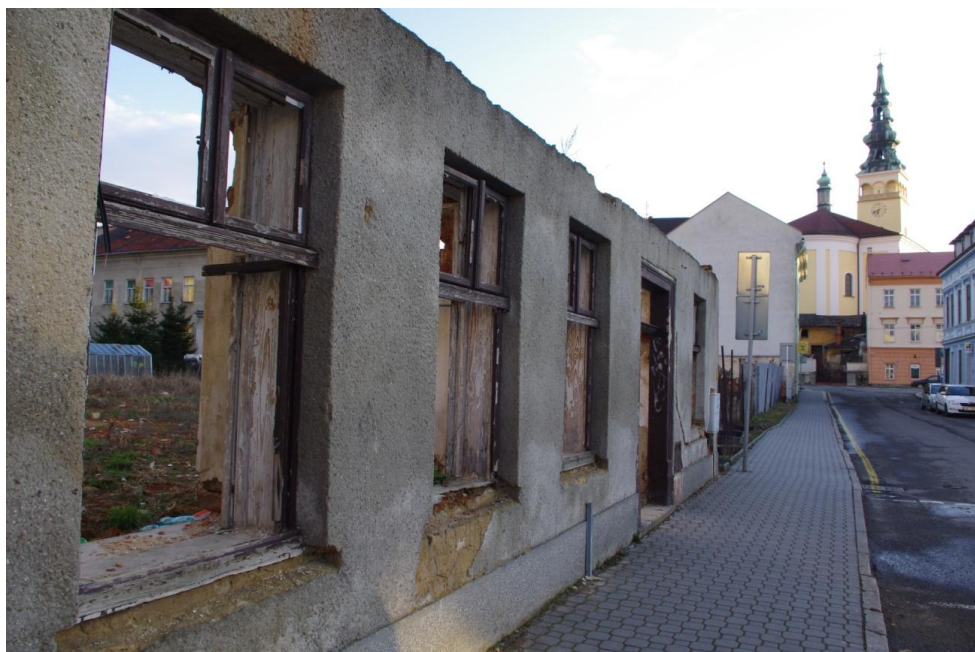
Obrázek č. 36: Zchátralá budova Dolní brány Zdroj: vlastní fotografie
