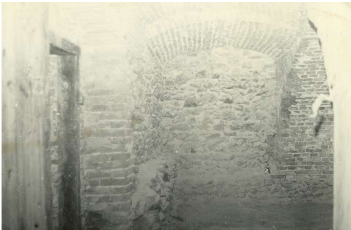
Obr. č. 7: Fotografie sklepů před sanací, 2PP, [6]
