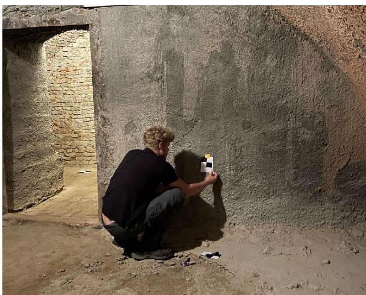
Obr. č. 11: Rozmístování VB a KB v prostorách 2PP, [Bc. Ondřej Pospíšil]
