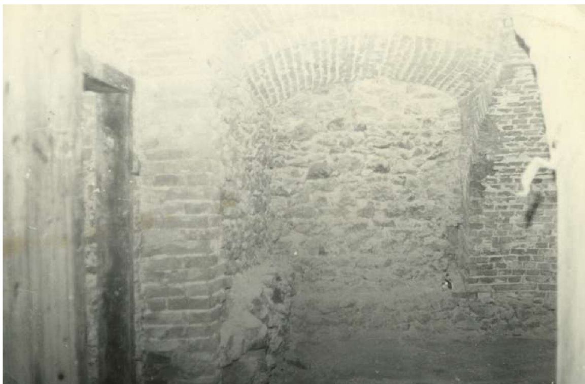
Obr. č. 7: Fotografie sklepů před sanací, 2PP, [6]
