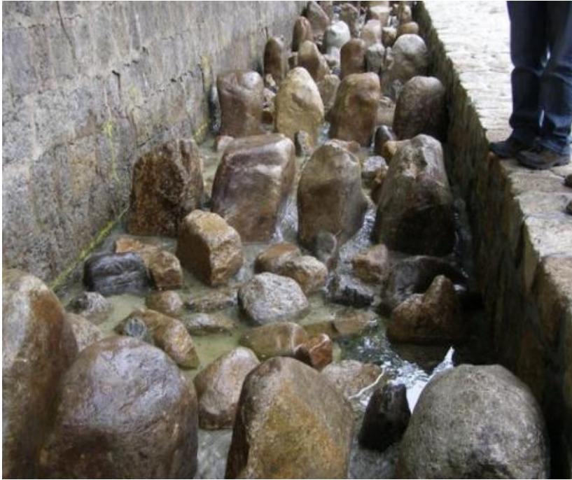
Rybí přechod 5 – příklad zdrsnění dna v RP (autor: Ing. Kamil Farský – AOPK ČR).
