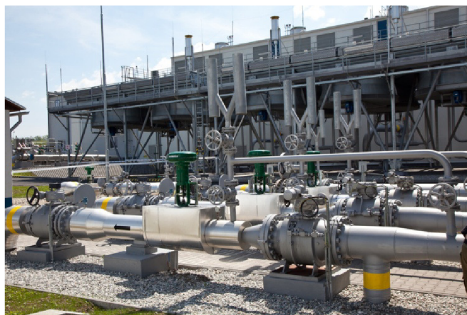
Obr. 9 : Podzemní zásobník plynu v Třanovicích (10)
