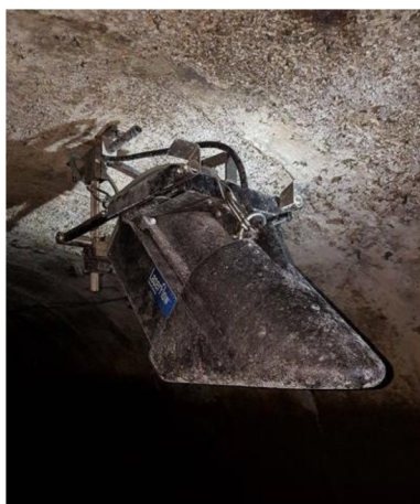
Obr. 3. 15. Osazený LaserFlow (foto: Jakub Lžičař)
