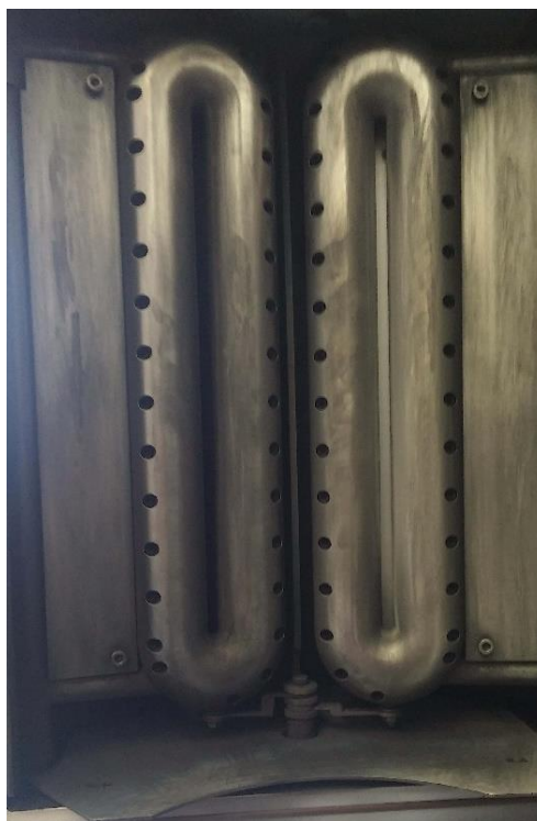
Obrázek 2.2: Fotografie filtru makročásteček ve dveřích povlakovací komory.
