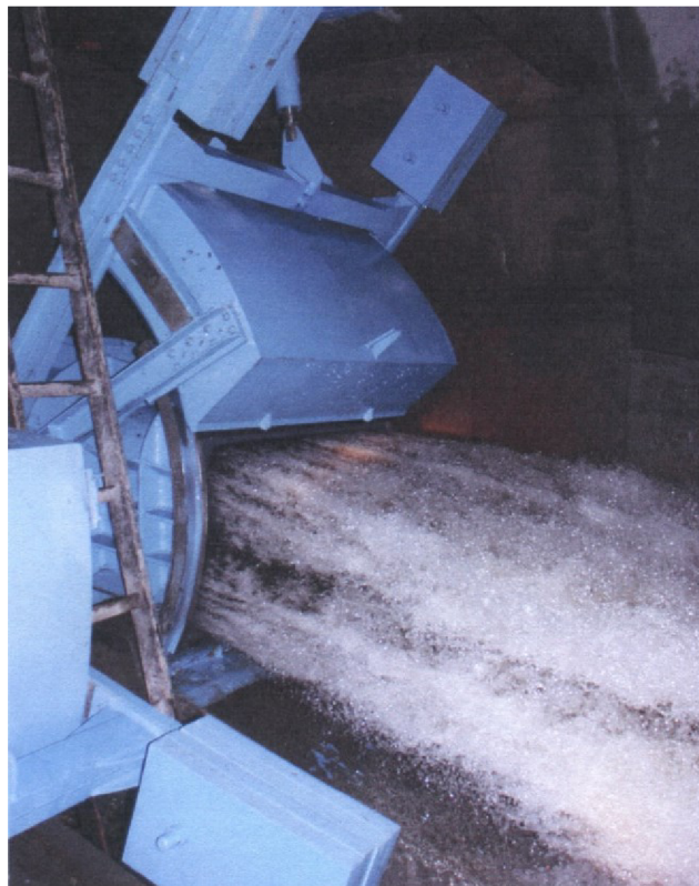
obr. 1.4 Spodní výpust DN 1000 na VD Souš se segmentovým uzávěrem, zdroj: archiv J. Šulce
