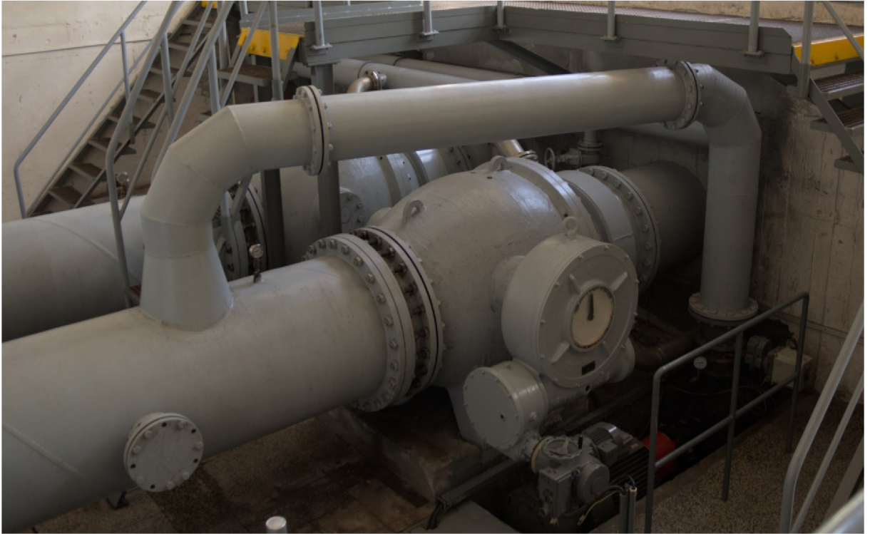
obr. 1.3 Kuželové uzávěry DN 800 uvnitř strojovny spodních výpustí na VD Boskovice
