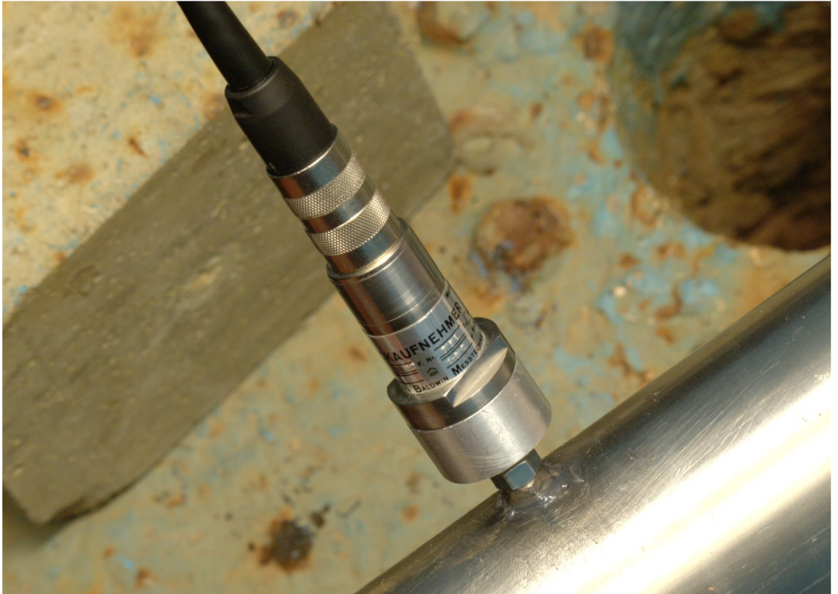
obr. 4.5 Detail napojení snímače tlaku na přívodní potrubí před RU
