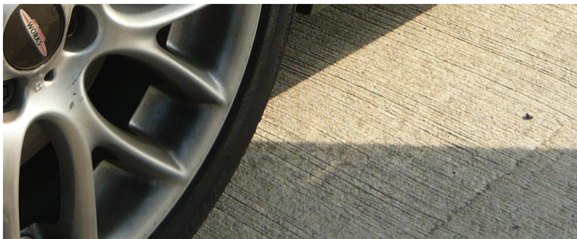
Obr. 8.1 Detail povrchu betonové plochy 108
