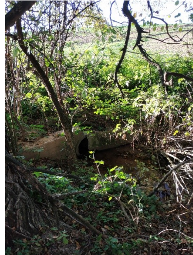
Obr. 55 Zaústění částečně funkčního drenážního systému
