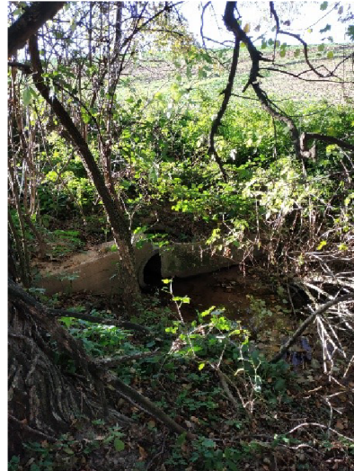
Obr. 55 Zaústění částečně funkčního drenážního systému
