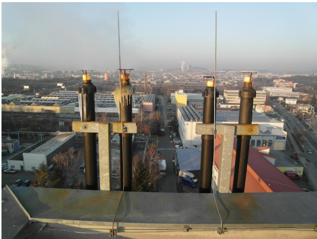
Příloha E: Komíny pro odchod spalin na střeše objektu.
