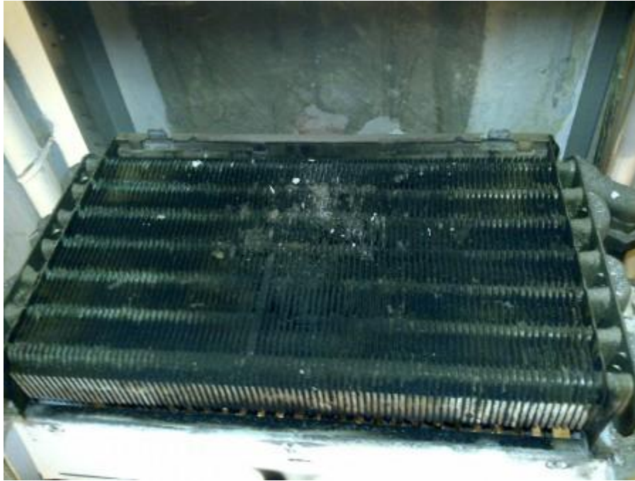
Obr. 9: Příklad zaneseného výměníku. Zdroj: http://servisplynospotrebicu.webnode.cz
