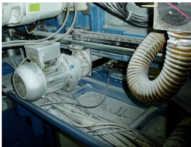
Obr. 8 – Stav stroje před vyčištěním
