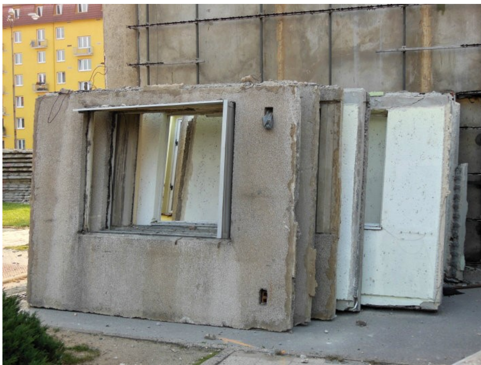
Obr. 23 Dekonstrukce objektu hotelu Dukla v Blansku: Demontované a odstrojené obvodové a vnitřní stěnové panely určené k separaci (Záboj 2015)
