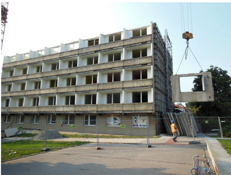
Obr. 22 Dekonstrukce objektu hotelu Dukla v Blansku: Transport panelu při využití metody shora-dolů (top-down) (Záboj 2015)
