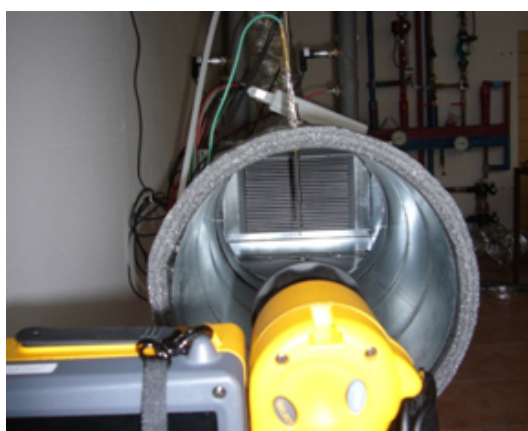
Obr. B.3: Pohled na výměník tepla ze strany termokamery.
