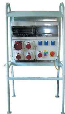
Obr. č. 32 Staveništní rozváděč [13]
