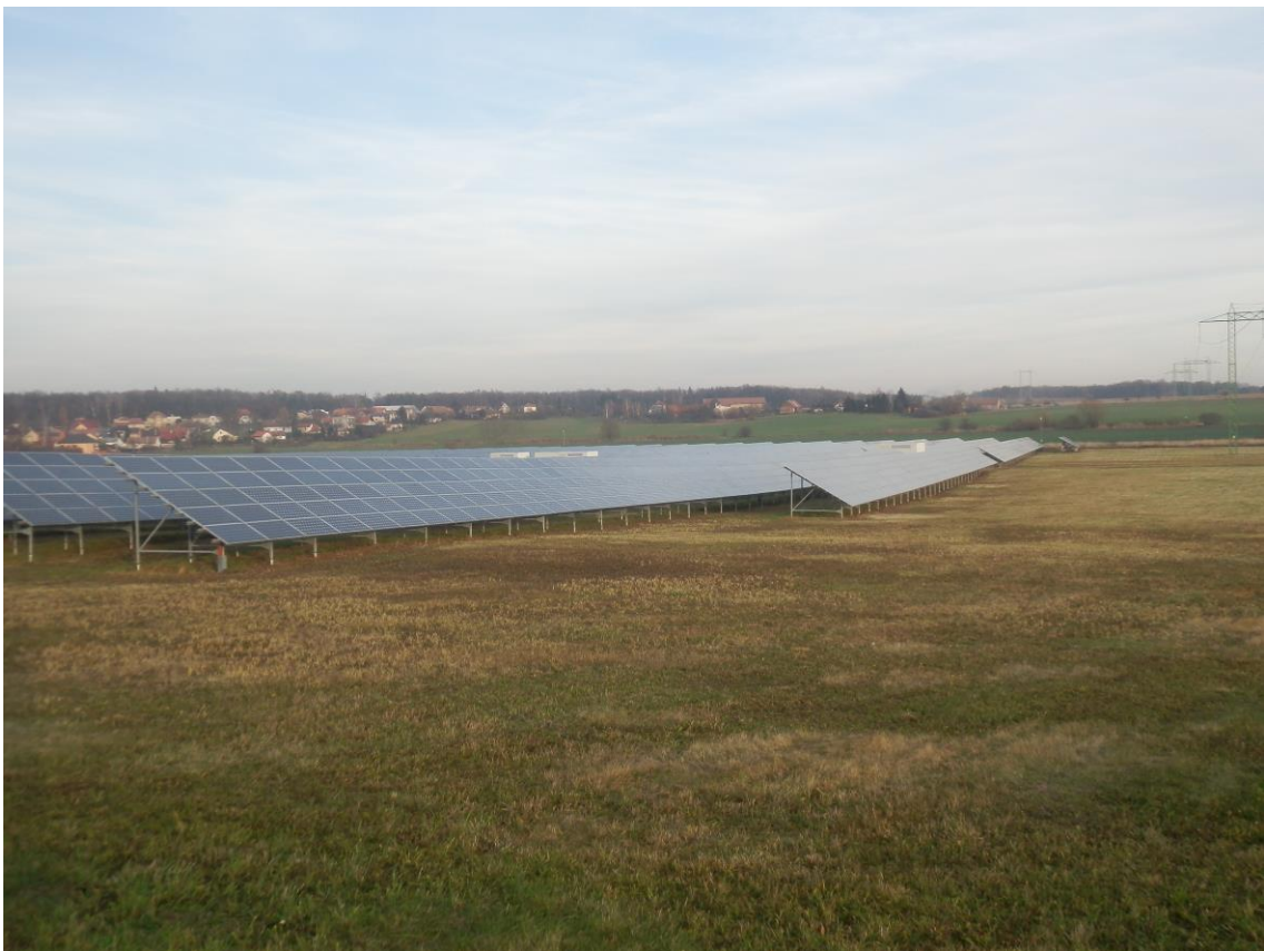
Příloha č. 3: Fotovoltaická elektrárna v části obce Klenovka (Zdroj: archiv autora)
