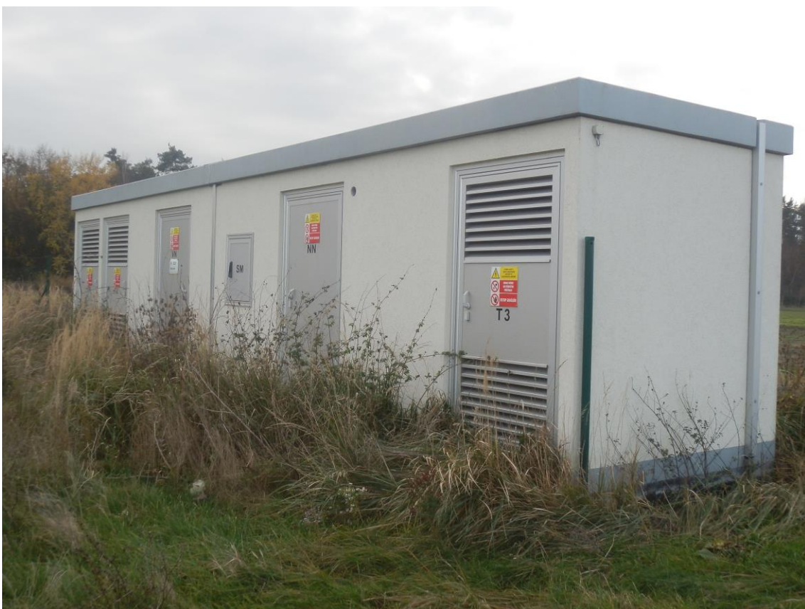
Příloha č. 13: Trafostanice dřívější fotovoltaické elektrárny v části obce Veská (Zdroj: archiv autora)
