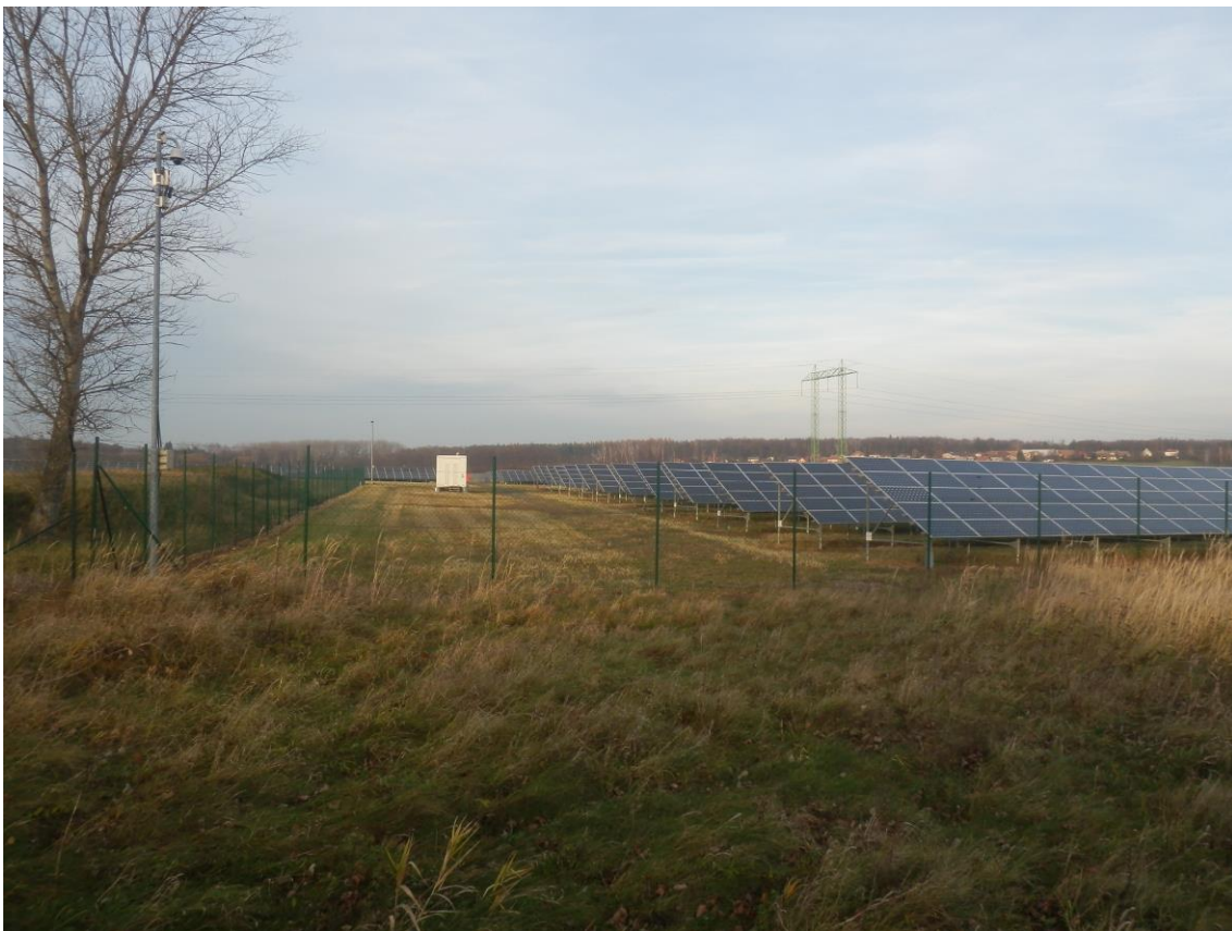
Příloha č. 5: Fotovoltaická elektrárna v části obce Klenovka (Zdroj: archiv autora)
