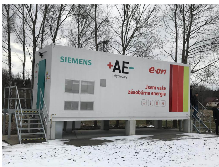
Obrázek 8 Velkokapacitní úložiště SIESTORAGE v Mydlovarech [63]
