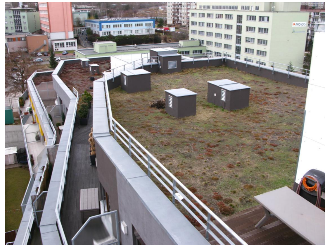
Foto 6: Kompletní pohled na odsazené střechy 6., 7. a 8. NP. Na nižších plochách "B" a "C" má výsadba méně prořídlý charakter. (Zdroj: autorka práce)
