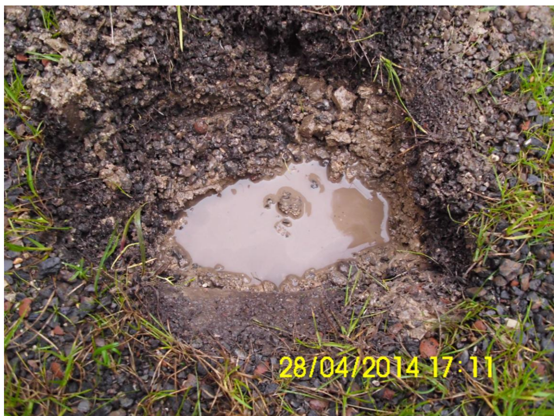
Foto 7: Detail substrátu na předzahrádkách - technologické pochybení na straně stavby při přejímce a instalaci substrátu a zároveň technologické pochybení dodavatele v kvalitě dodávky (Zdroj: zhotovitel stavby)
