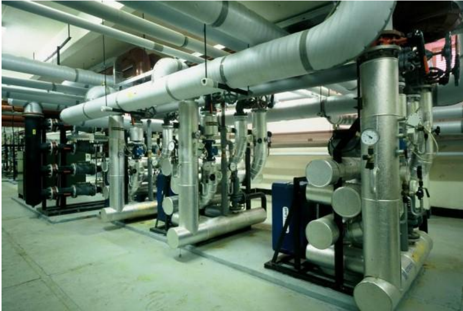
Obr. 1 Blokovaná výměníková stanice voda – voda [1]
