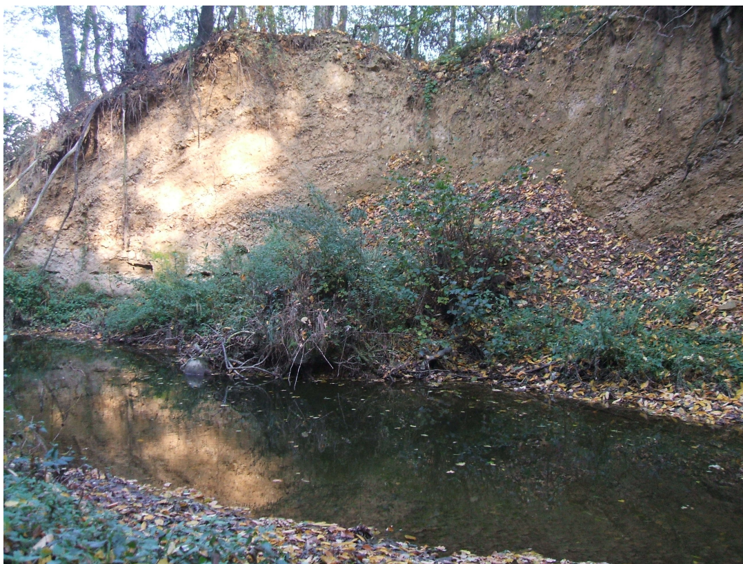
Obr. 4: Nezpevněné břehy Hvozdnice (1 km západně od obce Otice)
