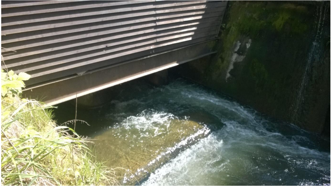
Obr. č. 10 Odpadní kanál i se savkami
