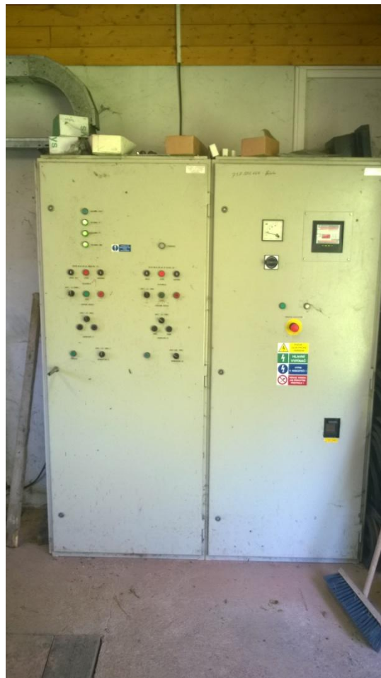
Obr. č. 9 Mozek strojovny, zde řídí automatika provoz elektrárny
