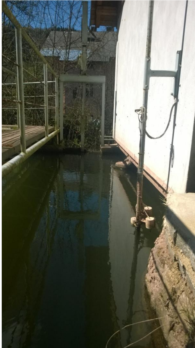
Obr. č. 5 Jalová propust a čidla pro automatické řízení
