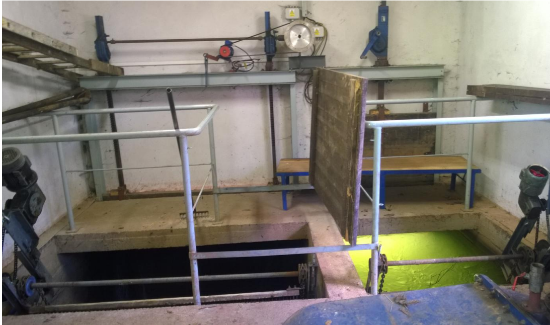
Obr. č. 8 Vnitřek strojovny se stavidly a hrabáčkami
