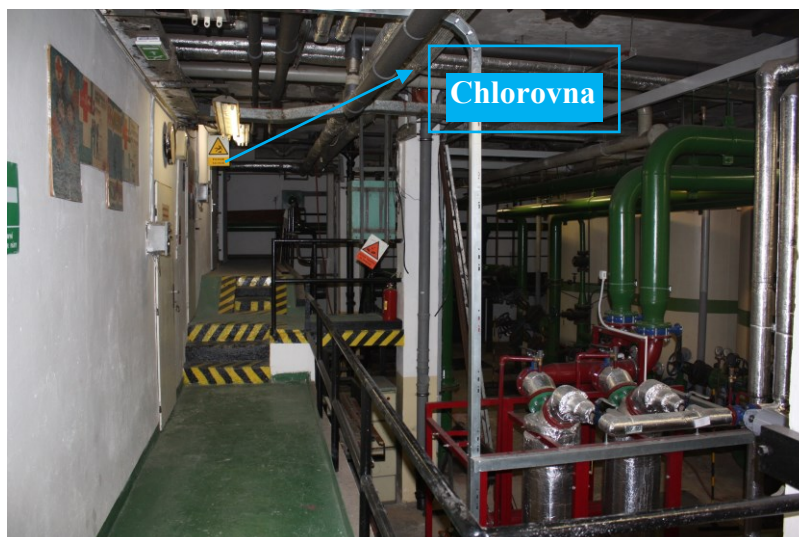
Obr. č. 6 – Umístění chlorovny ve strojovně [foto vlastní]
