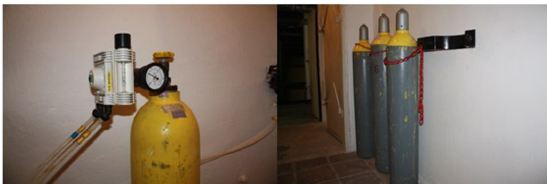
Obr. č. 7 – Tlaková láhev připojená k chlorátoru a skladované tlakové láhve s Cl 2 v chlorovně [foto vlastní]
