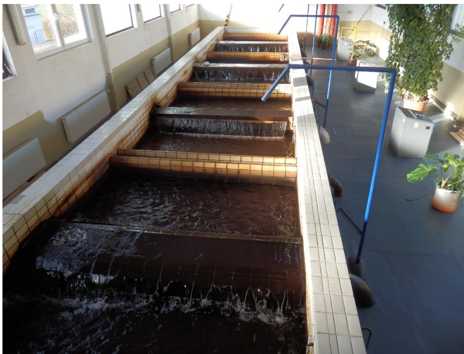
Příloha Obr.3 – Úpravna vody Mokošín – interiér (ŠAFRÁNKOVÁ, 2015 (archiv autorky))
