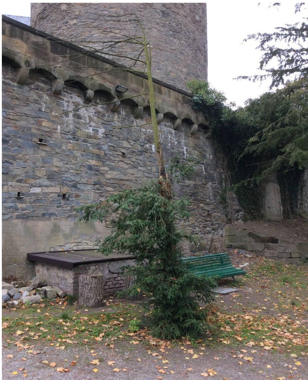
foto 11: Tis červený ( Taxus baccata ), zámecká zahrada (Žatec), akutní riziko odumření, zlom hlavního kmene, 30. 9. 2014
