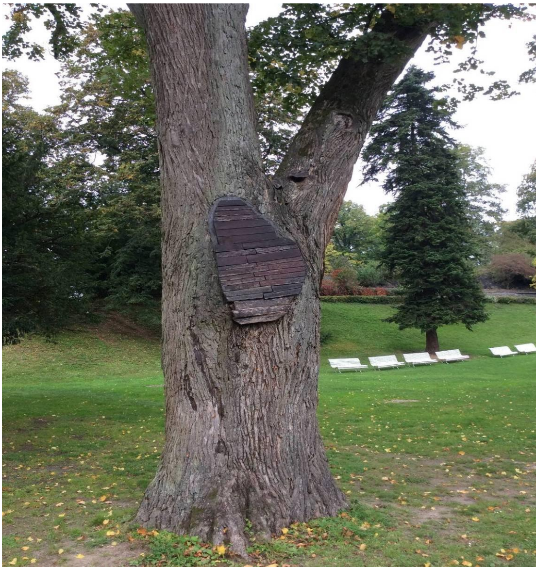
foto 8: Lípa srdčitá ( Tilia cordata ), zámecká zahrada (Žatec), zabetonovaná dutina kmene stromu, 30. 9. 2014
