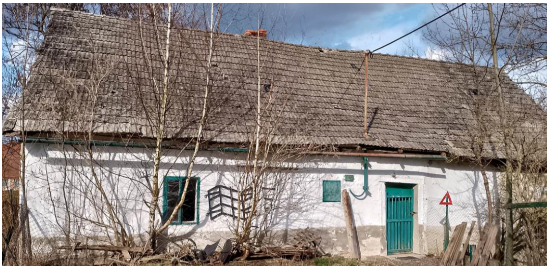
Obrázek 18 Chátrající objekt v Záblatí č.p. 27 (Kotačková, 2023)
