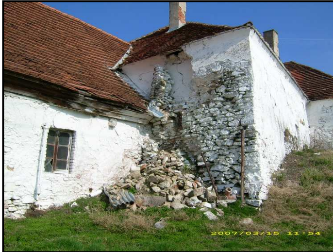
Obr.109 - zčásti zbořený nárožní opěrák
