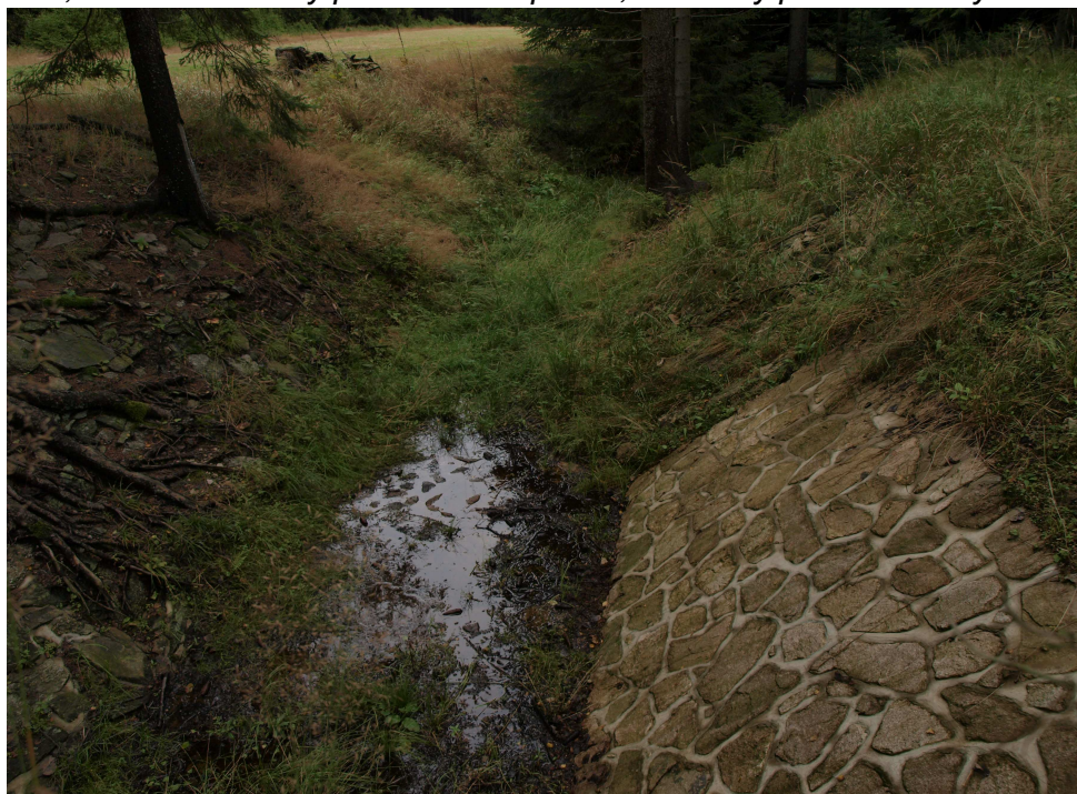
Obr. č. 4, Ukončení dlažby pod mostním polem, betonový práh zcela chybí
