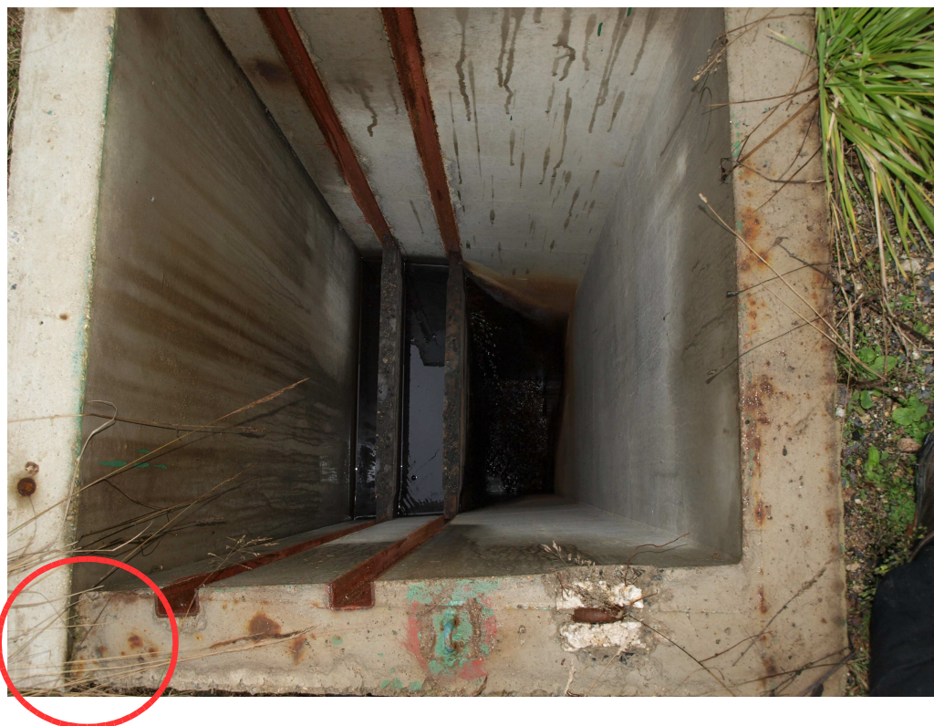
Obr. č. 5, Těleso požeráku není jednolitě
