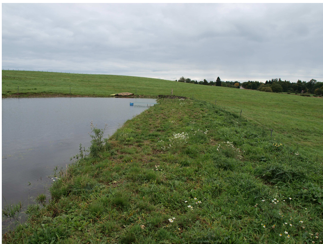
Obr. č. 7, Tělesohráze bez bezpečnostního přelivu, pod nádrží chybí šachtice
