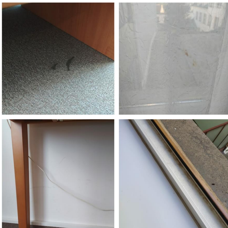
Obrázek 12 - Skvrny v hotelovém pokoji Mědínek na koberci, zácloně, stěně a špinavý rám u okna Zdroj: vlastní fotografie
