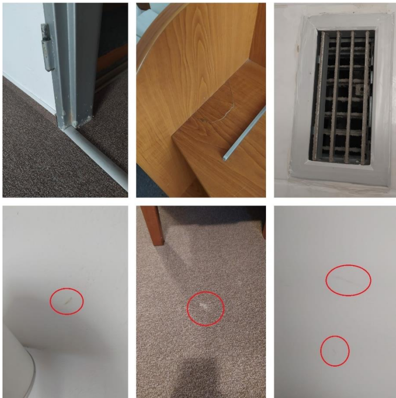
Obrázek 13 - Špinavý rám, rozbitý obuvník, zaprášená ventilace, černé šmouhy na stěnách a bílý flek na koberci v hotelovém pokoji Mědínek Zdroj: vlastní fotografie
