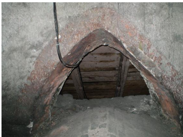
87. Olomouc, kostel sv. Kateřiny, půdní prostor, záklenek zaniklého okna (v místě dnešní barokní kaple u severovýchodního průčelí). Foto: Klára Mezihoráková
