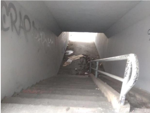
Obr. č. 42: Podchod – Lehovec (III) (zdroj: autor 2018)
