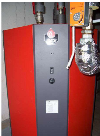
Obrázek 36 Ohříváč teplé vody
