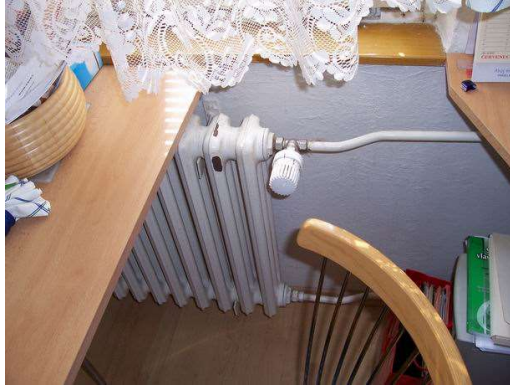
Obrázek 35 Otopné těleso v bytě
